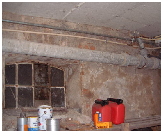
erhebliche Feuchtigkeit in den Kellerräumen; zusätzliche Installation einer kontrollierten Lüftungsanlage
