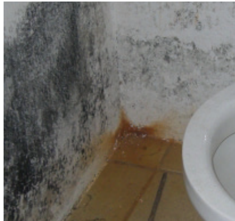
Schimmelbildung im Feuchtraum
