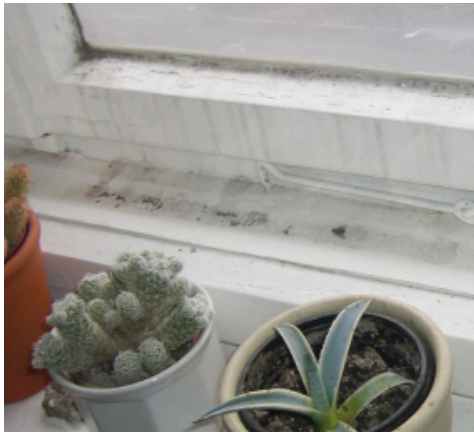
Feuchteschaden am Fenster
