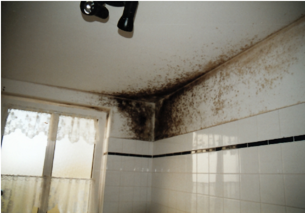
Bild 2: Ausgeprägte Schimmelpilzbildung im Außenwandbereich
