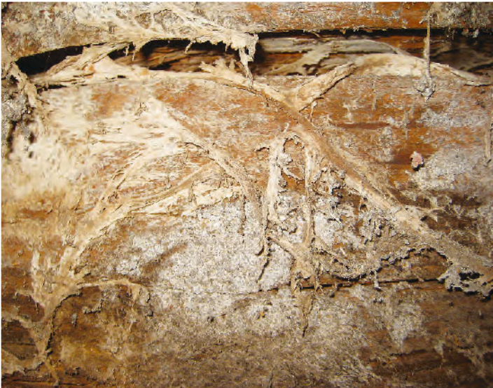
Dicke Mycelstränge des Echten Hausschwamms an einem stark befallenen Holzbalken
