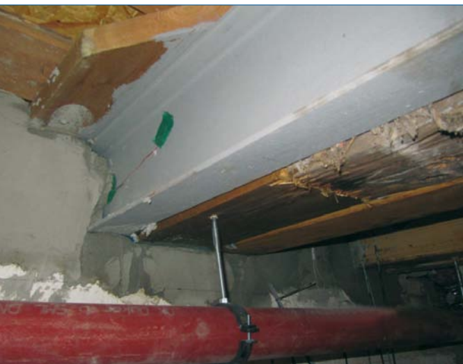
Zusätzlicher Stahlträger neben ausgebesserten Balken und Sensor zur begleitenden Untersuchung der thermischen Bauphysik
