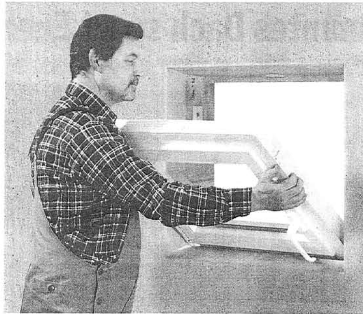
Nicht einfach nur ein Loch in die Wand hauen - das Einsetzen zusätzlicher Fenster erfordert akribische Planung. Dabei muss vor allem die Statik berücksichtigt werden. Foto: gms
