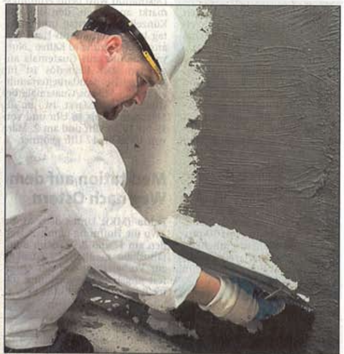
Nicht ganz dicht: Dringt Feuchtigkeit in den Keller ein, ist die nachträgliche Abdichtung von außen eine Option. Ist dies zum Beispiel aus Platzmangel nicht möglich, wird innen Hand angelegt. Foto: MK
