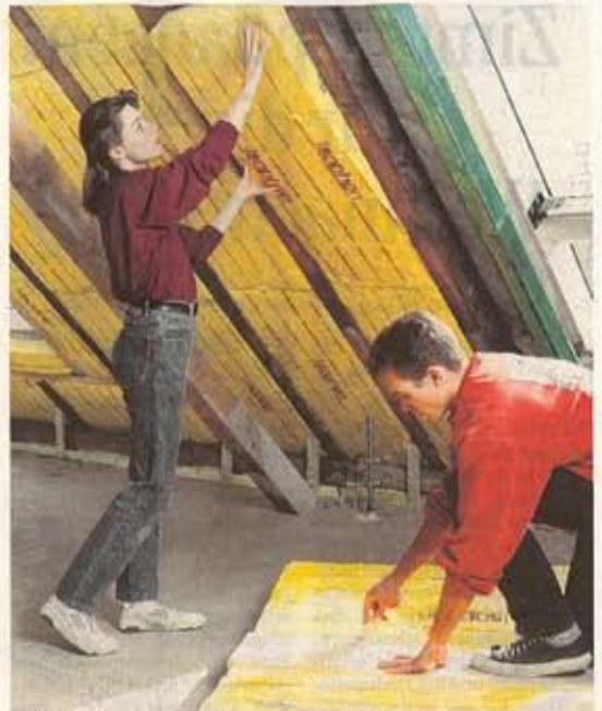
Nach guter Beratung kann die Dämmung auch in Eigenregie angebracht werden. Die Auswahl des passenden Materials ist wichtig
