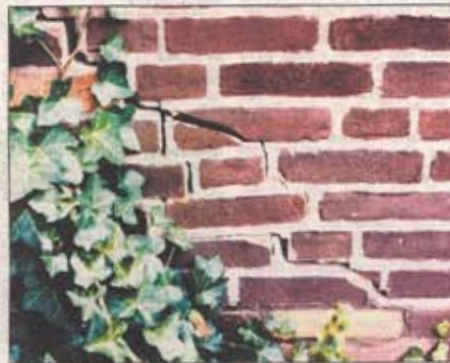
DURCH AUSTROCKNUNG des Bodens entstehen Risse in Mauern, durch die Feuchtigkeit eindringt. Foto: gms
