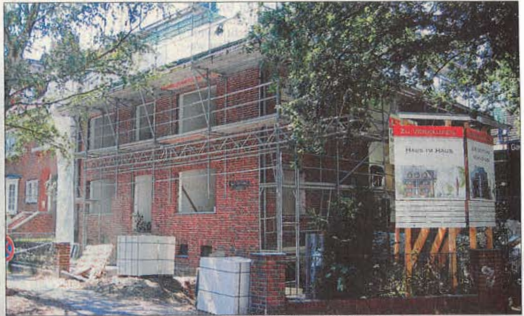
Aussagekräftige Zahl: Bereits das Baujahr kann bei Bestandsimmobilien Aufschluss über den wahrscheinlich anstehenden Sanierungsaufwand geben. Foto: Felix Rehwald
