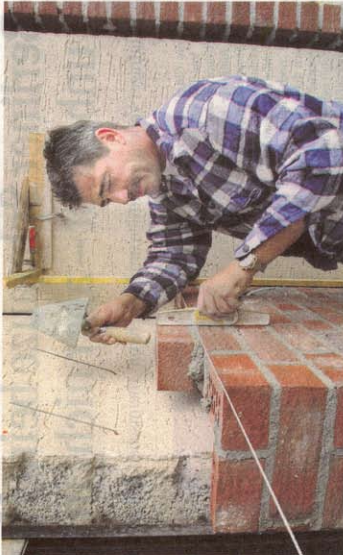
Auch eine Dämmung: Mit einer zusätzlichen Klinkerstein-Schicht erhöht sich die Qualität der Außenwand
