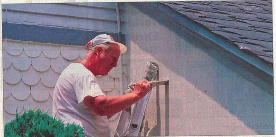
Eine optische und energetische Sanierung der Hausfassade steigert den Wert der Immobilie. Foto: nh
