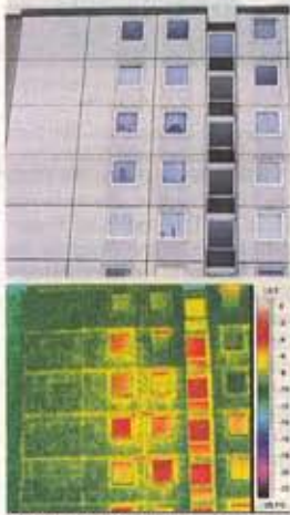
Noch viel zu dämmen: Fotos der Infrarotkamera zeigen Schwachstellen
