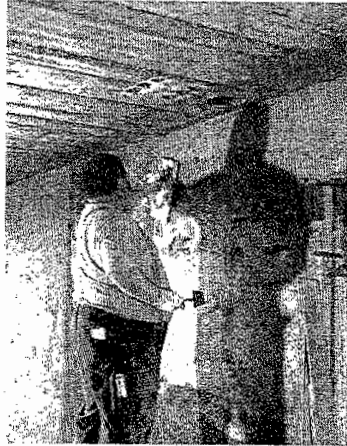
Kleine Risse lassen sich schnell beseitigen. Breitet sich der Riss aber aus, sollte der Fachmann gerufen werden.
