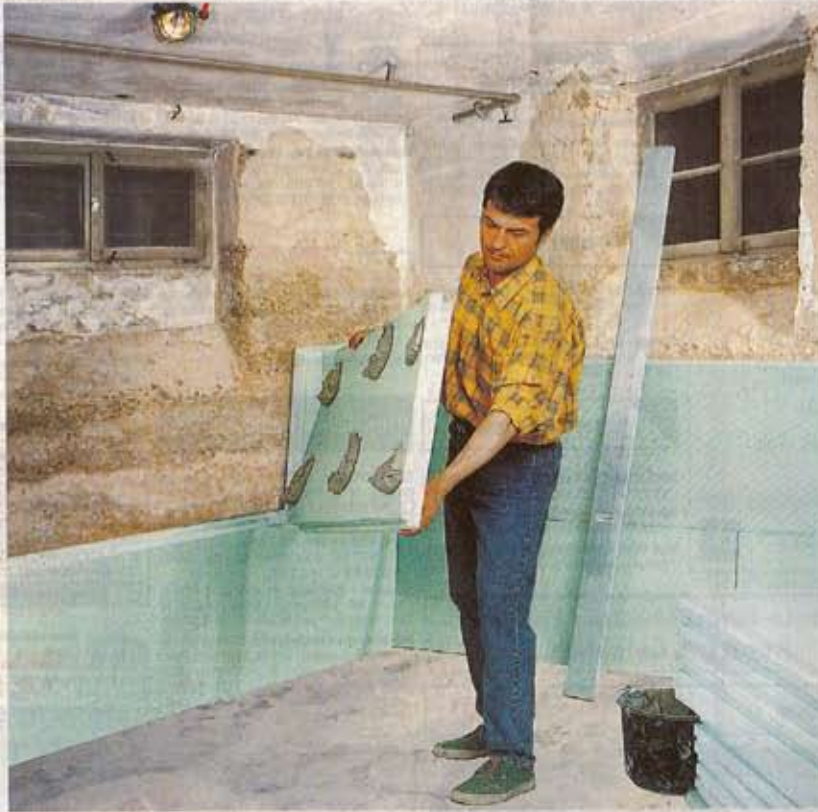
In alten Kellern ist eine Innendämmung oft die einzige Lösung, um die Kälte auszusperren.
