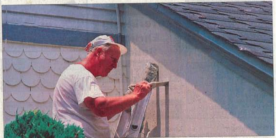
Eine optische und energetische Sanierung der Hausfassade steigert den Wert der Immobilie. Foto: nh
