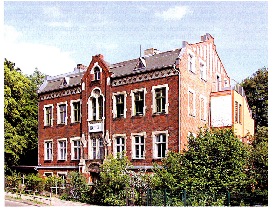
Das feuchtegeschädigte ehemalige Gemeindehaus wurde unter Mithilfe von Remmers seiner neuen Bestimmung zugeführt.
