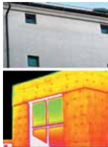
Mögliche Schadensbilder bei herkömmlicher Dübelung.
