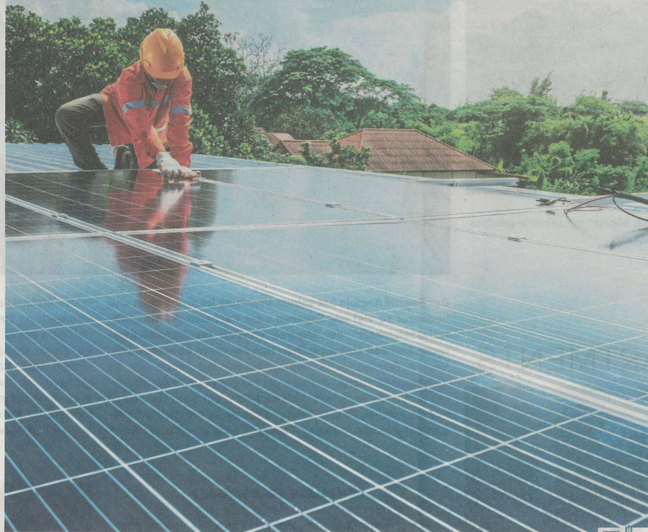
Handwerker bei der Installation einer Fotovoltaikanlage. Auch für Sonnenstrom gibt es neue Kredite
